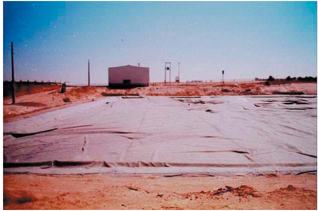
120 000 откормочных боровов, компания Agricola Super Ltda, Чили. Биогазовая станция, включающая в себя смешительно-отстойную емкость с подогревом (умеренный климат).
